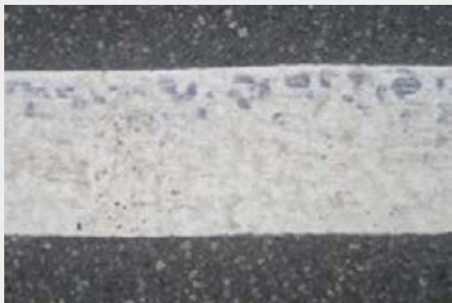
Ejemplo de línea continua dañada
